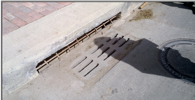
Figura 7. Sumidero en la parte baja de la pendiente de la vía de acceso a la obra.
