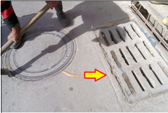
Figura 5. Sumidero desprotegido en la entrada de la obra
