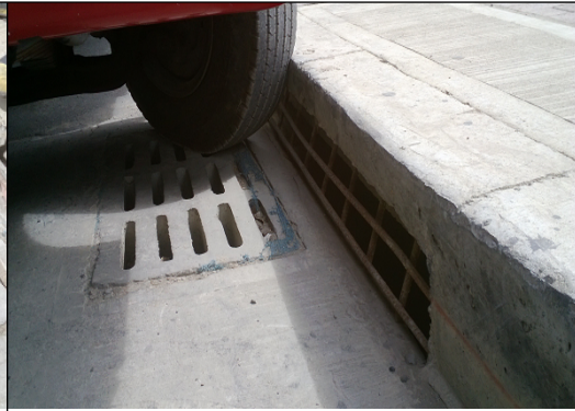
Figura 6. Sumidero desprotegido frente a la obra
